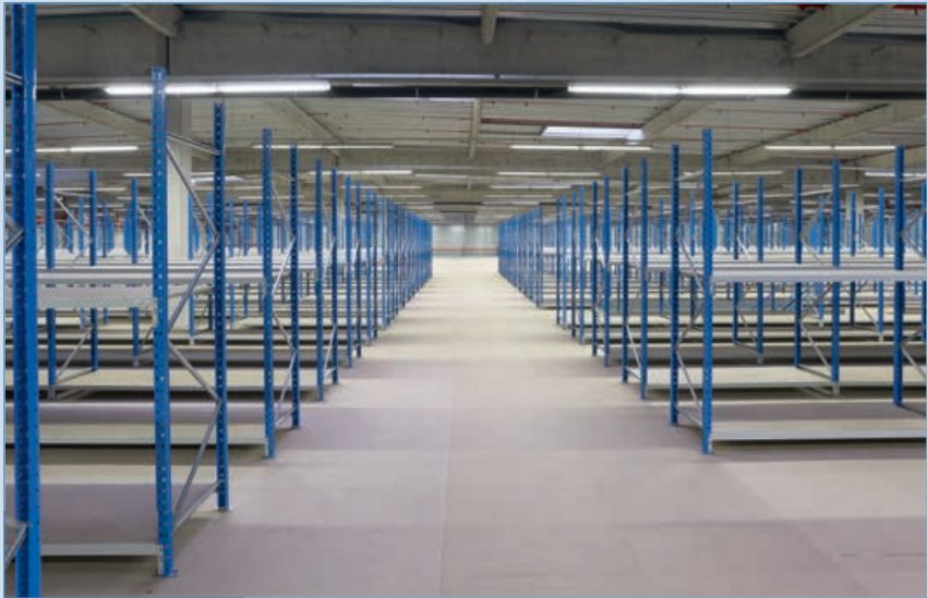
Installatie op 2000 m 2 bij standaardopslag van dozen
